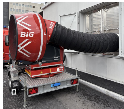
Abb. 2: MGV im Saugbetrieb (2x 3 m Lutte an Andockstelle)
